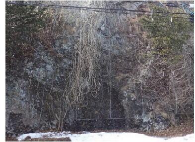
21：急斜面地崩落防止ネット
