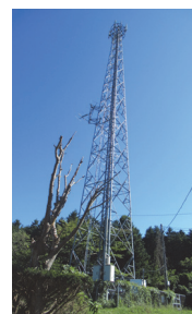
36：携帯電話通信施設
