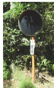
40：道路附属物「カーブミラー」
