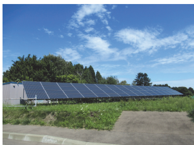
32：太陽光発電施設
