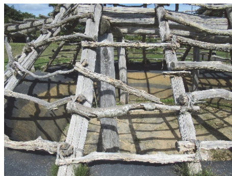
写真7-1 老朽化した骨組
