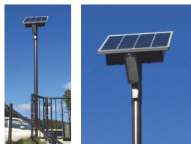
7：ソーラーポール街路灯
