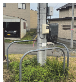
27：携帯電話通信施設
