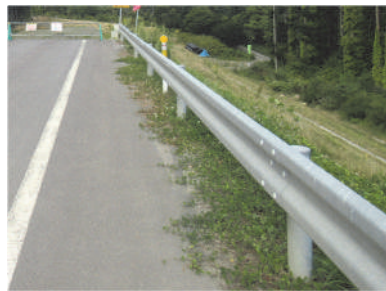
33：ガードレール
