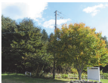
41：電柱 「管理棟東側」
