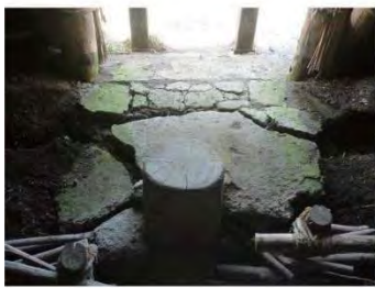
劣化した入口のモルタル
