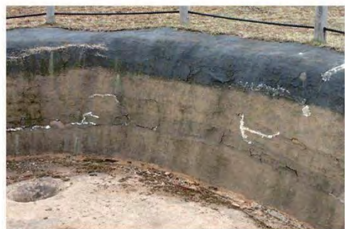
樹脂製壁面の亀裂
