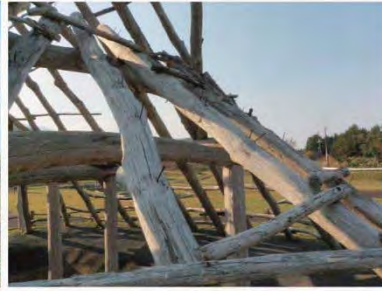
エツリの脱落
