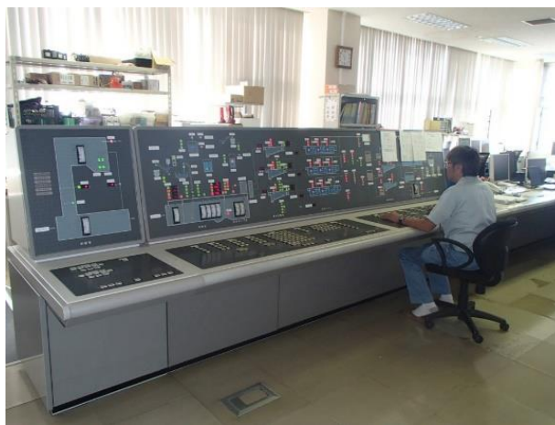
汚水処理施設運転管理
