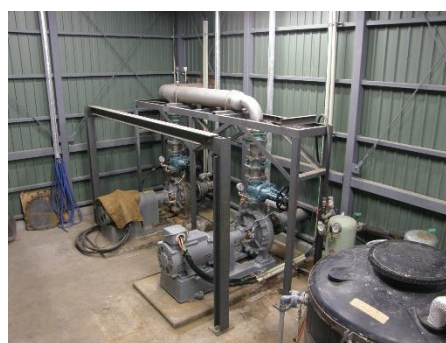
温泉供給ポンプ
