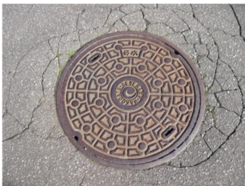
水密性の低いマンホール蓋
