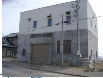
志海苔ポンプ場 (汚水)
