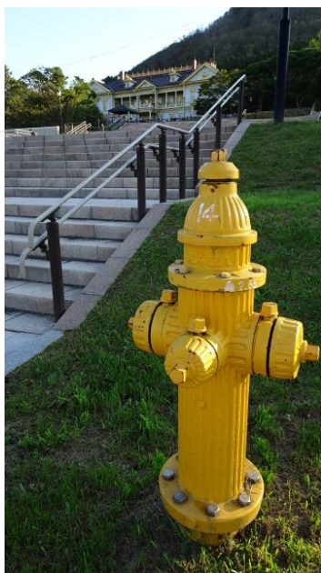
函館市型地上式消火栓
