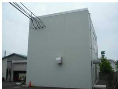
駒場町変電所
