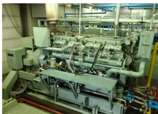
ガス発電設備
