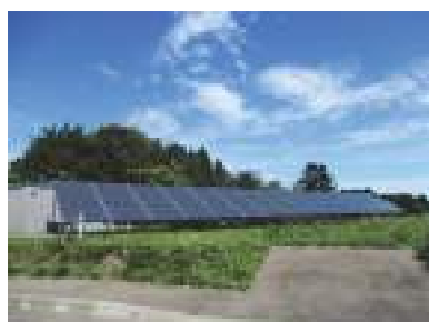
32：太陽光発電施設
