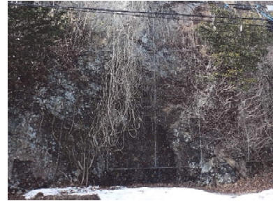
21：急斜面地崩落防止ネット
