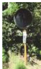
40：道路附属物 「カーブミラー」
