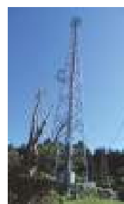
36：携帯電話通信施設
