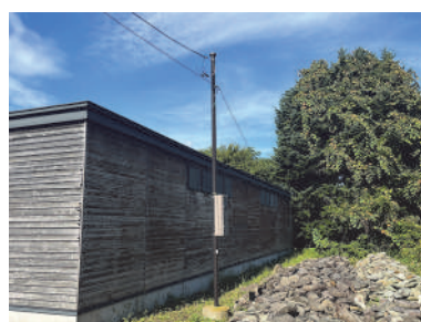
41：電柱 「管理棟北側」
