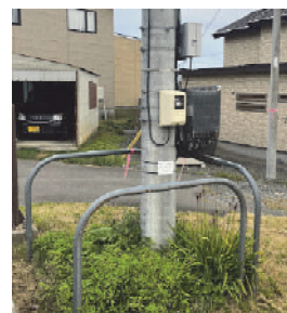
27: 携帯電話通信施設
