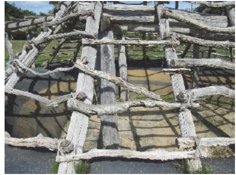
写真7-1 老朽化した骨組
