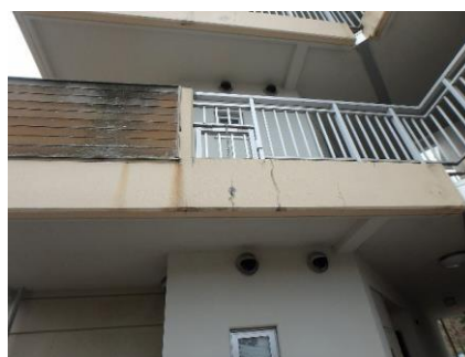
弥生団地(特公賃)：鉄筋露出、ひび割れ
