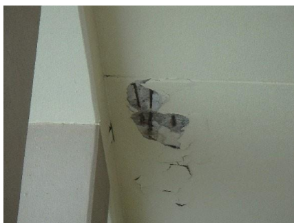
湯浜団地(2号棟)：鉄筋露出
