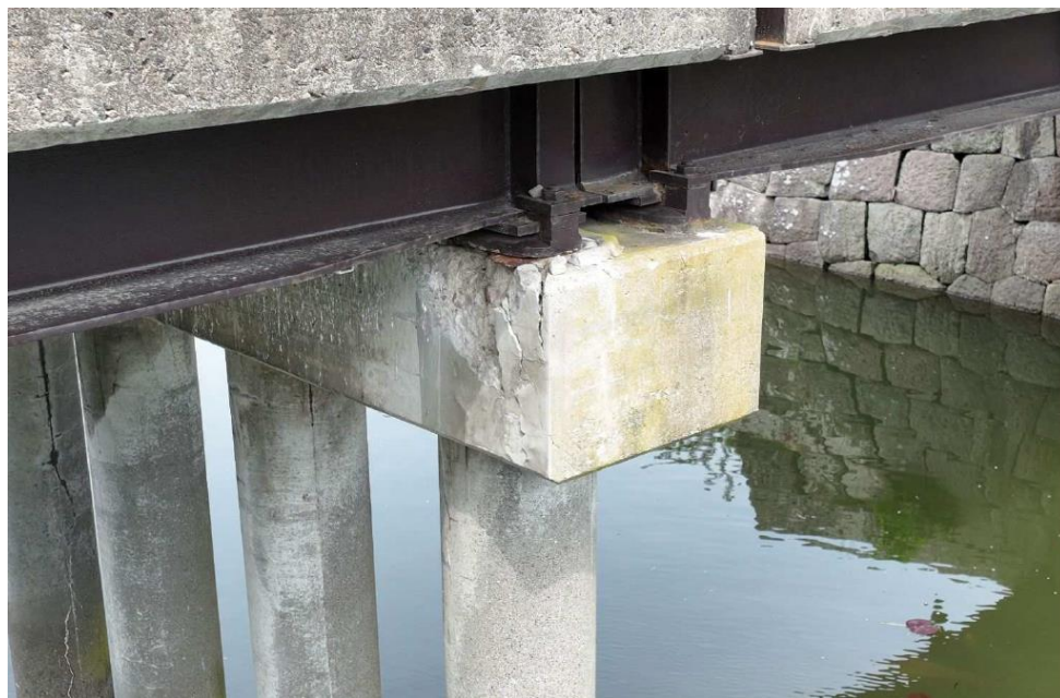
クラック箇所拡大写真
