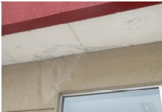
軒天井漏水跡
