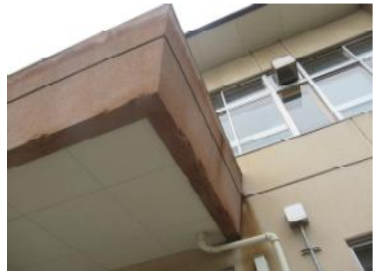
庇パラペット劣化
