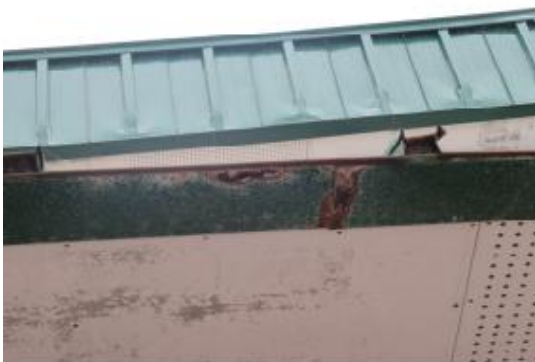
軒先・屋根腐食
