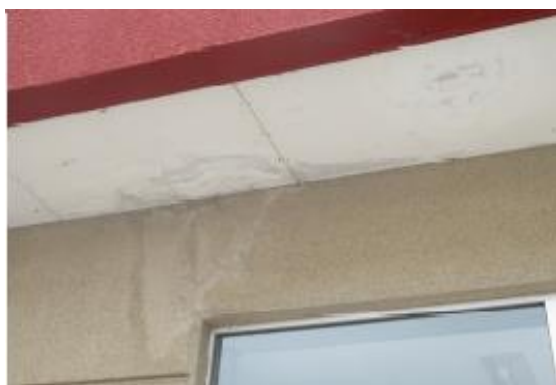
軒天井漏水跡
