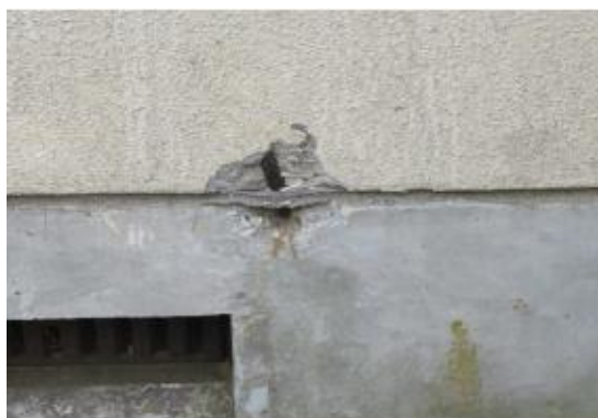
外壁・基礎爆裂
