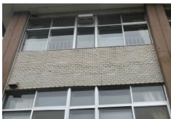
外壁タイル割れ・浮き上がり
