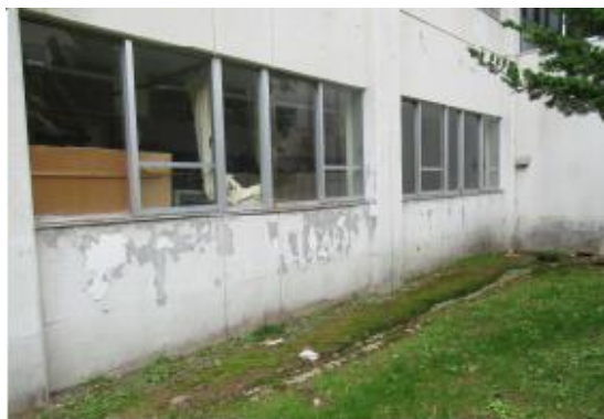
塗装仕上げ剥離
