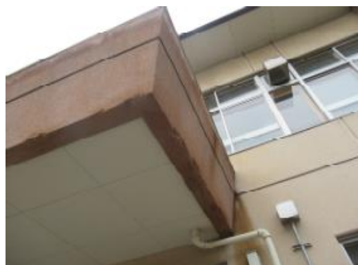
庇パラペット劣化
