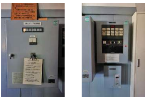
写真 4-3. 消火ポンプ制御盤・火災受信機
