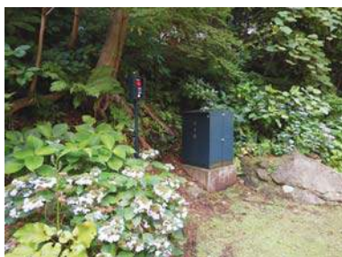
【防災設備】昭和57年
