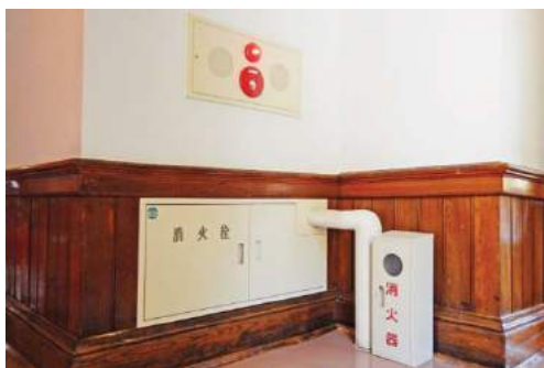
写真 4-1. 屋内消火栓、発信機、消火器
