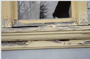
窓台の腐朽(本館 東面)
