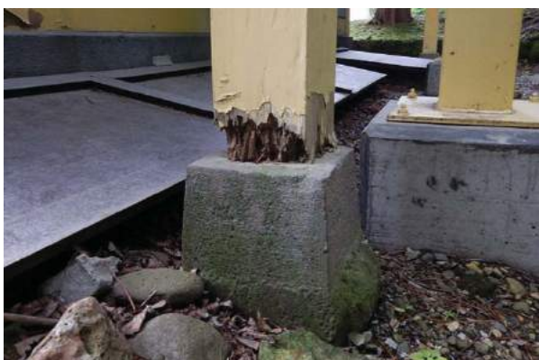
柱根の腐朽 (本館突出部)
