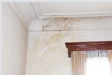
漆喰の汚損・割損(本館1階 予備室)
