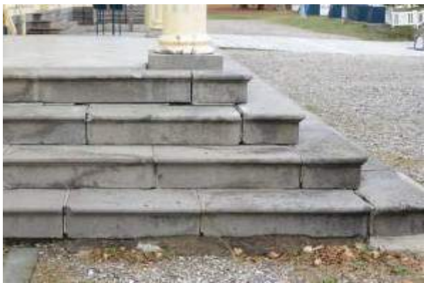
石段のゆるみ (本館車寄せ)
