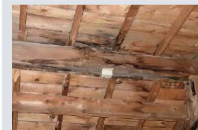
雨漏り(本館 小屋組)
