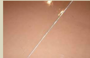
塩ビシートの浮き(本館2階 演壇)
