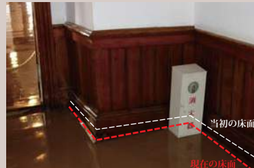
床の不陸(本館2階 廊下)
