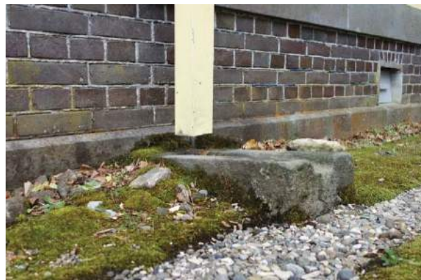
礎受石の不陸 (本館西側)
