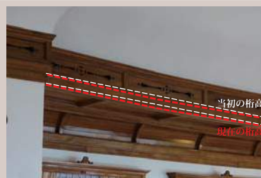
天井の垂下(本館2階 大広間)
