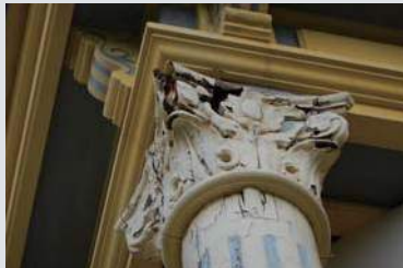
柱頭の腐朽(本館 西側車寄せ)
