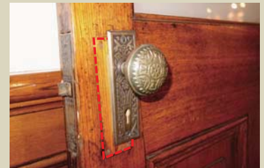
建具金物のずれ (本館会議所役員室)
