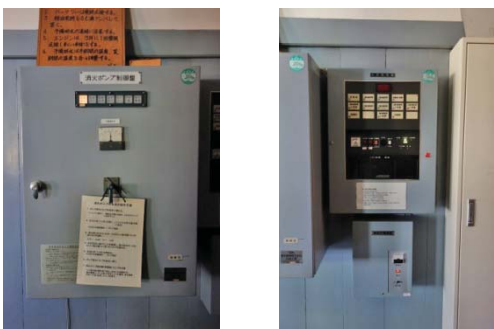
消火ポンプ制御盤・火災受信機
