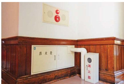
屋内消火栓、発信機、消火器
