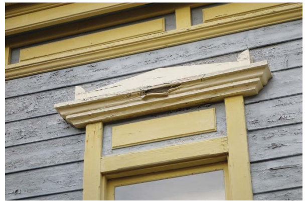
窓飾りの腐朽（本館東側）
