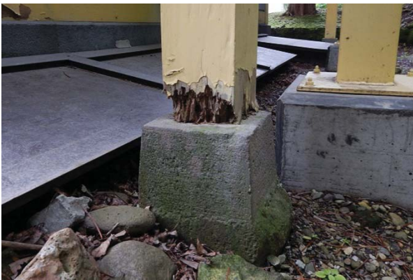
柱根の腐朽（本館突出部）
