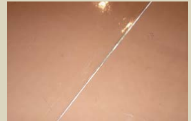
塩ビシートの浮き (本館演壇)
