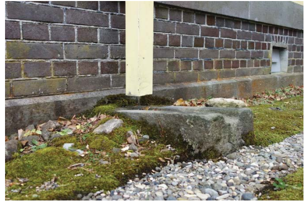
樋受石の不陸（本館西側）
