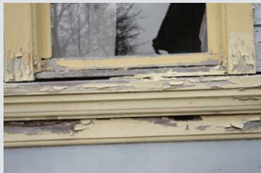
窓台の腐朽 (本館東面)
