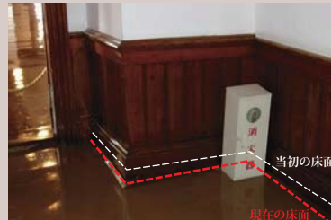
床の不陸 (本館2階廊下)
