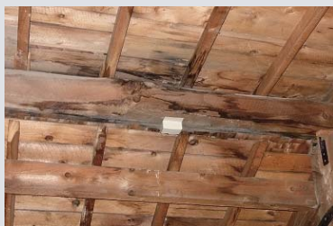
雨漏り (本館小屋組)
