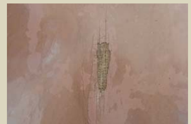
リノリウムの破損 (本館会議所役員室)
