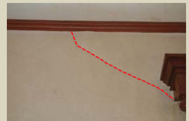
壁紙の割れ (御食堂)
