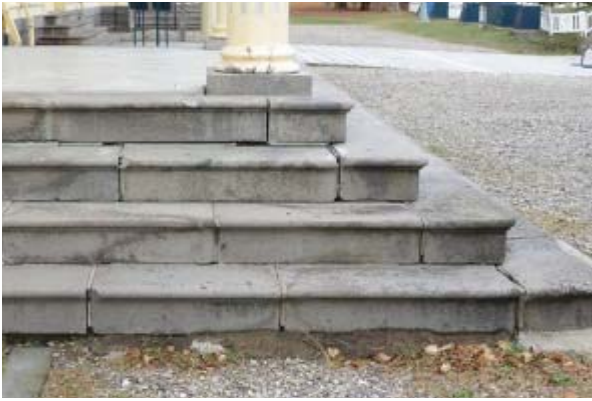
石段のずれ、不陸（本館車寄せ）
