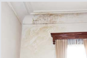
漆喰の汚損・割損 (予備室)
