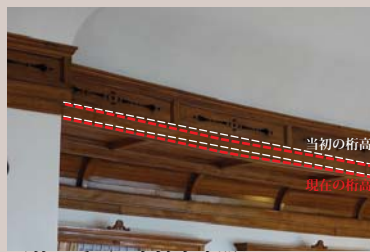
天井の垂下 (本館大広間)
