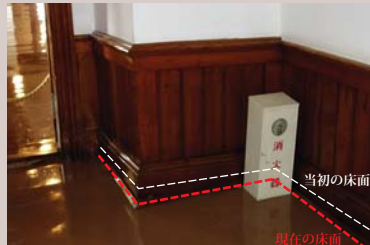
床の不陸 (本館2階廊下)
