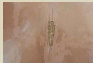
リノリウムの破損 (本館会議所役員室)
