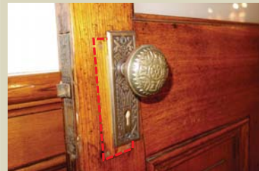
建具金物のずれ (本館会議所役員室)
