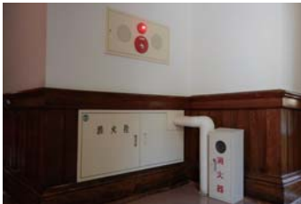
屋内消火栓 (本館2階西側)
