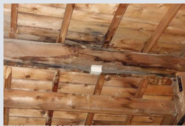
雨漏り (本館小屋組)
