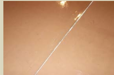
塩ビシートの浮き (本館演壇)
