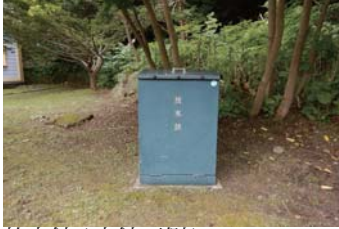
放水銃 (本館西側)
