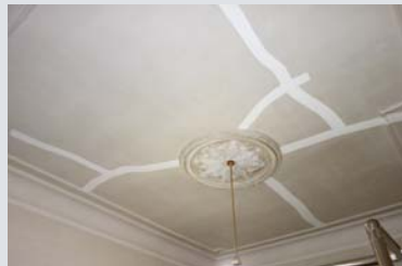
天井の汚損・割損 (本館会議所役員室)
