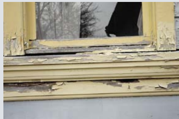
窓台の腐朽 (本館東面)
