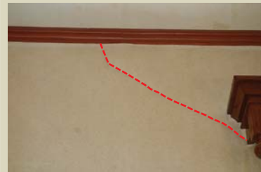
壁紙の割れ (御食堂)
