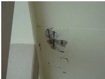
湯浜団地(2号棟)：鉄筋露出
