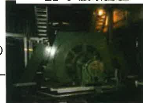
図2-1 非常用ディーゼル発電機
