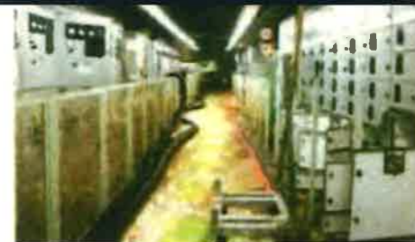
図2-6 浸水した配電盤
