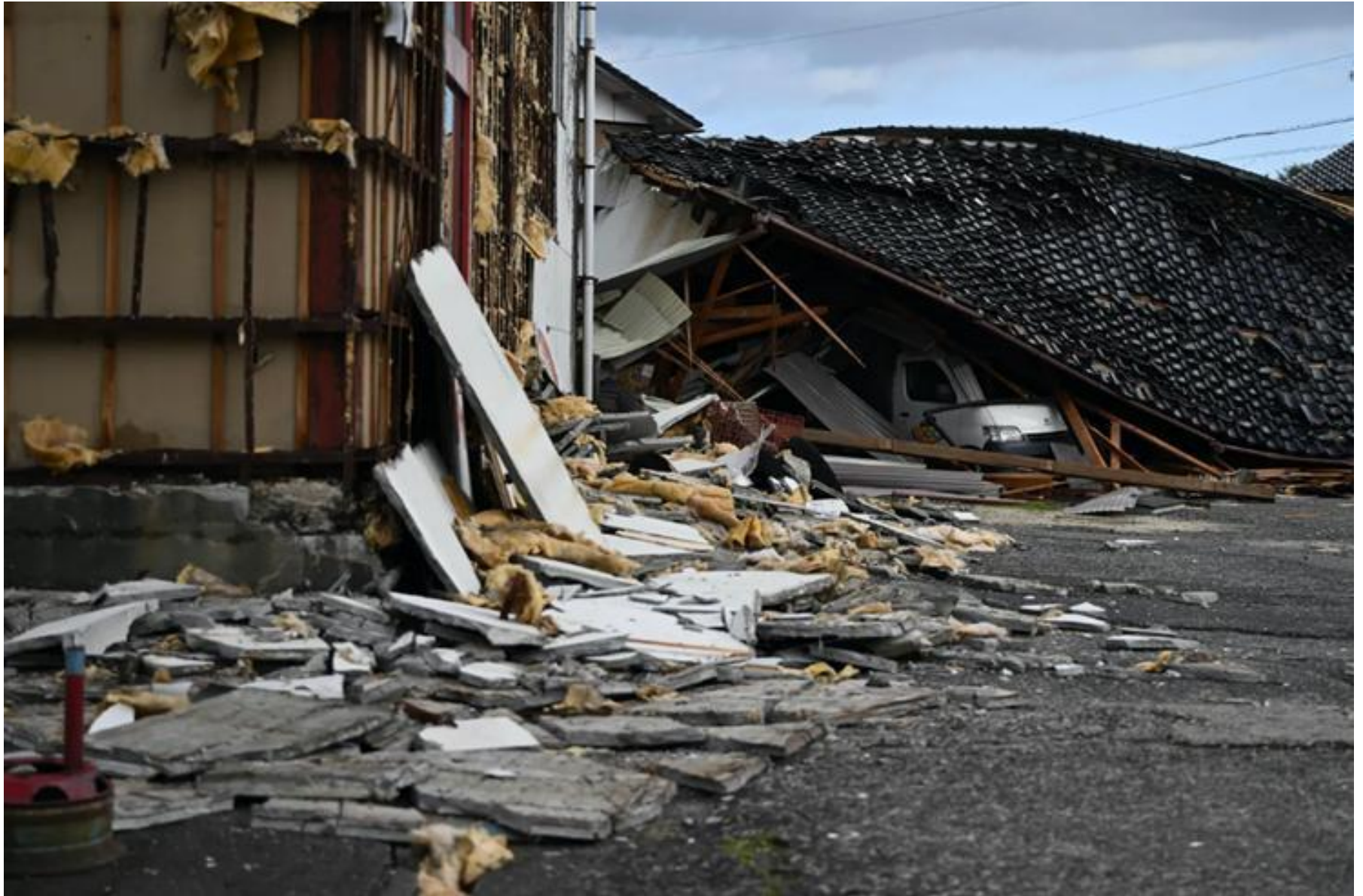
穴水町 震度6強 被害棟数2063棟(1月29日時点)(甲F163)
