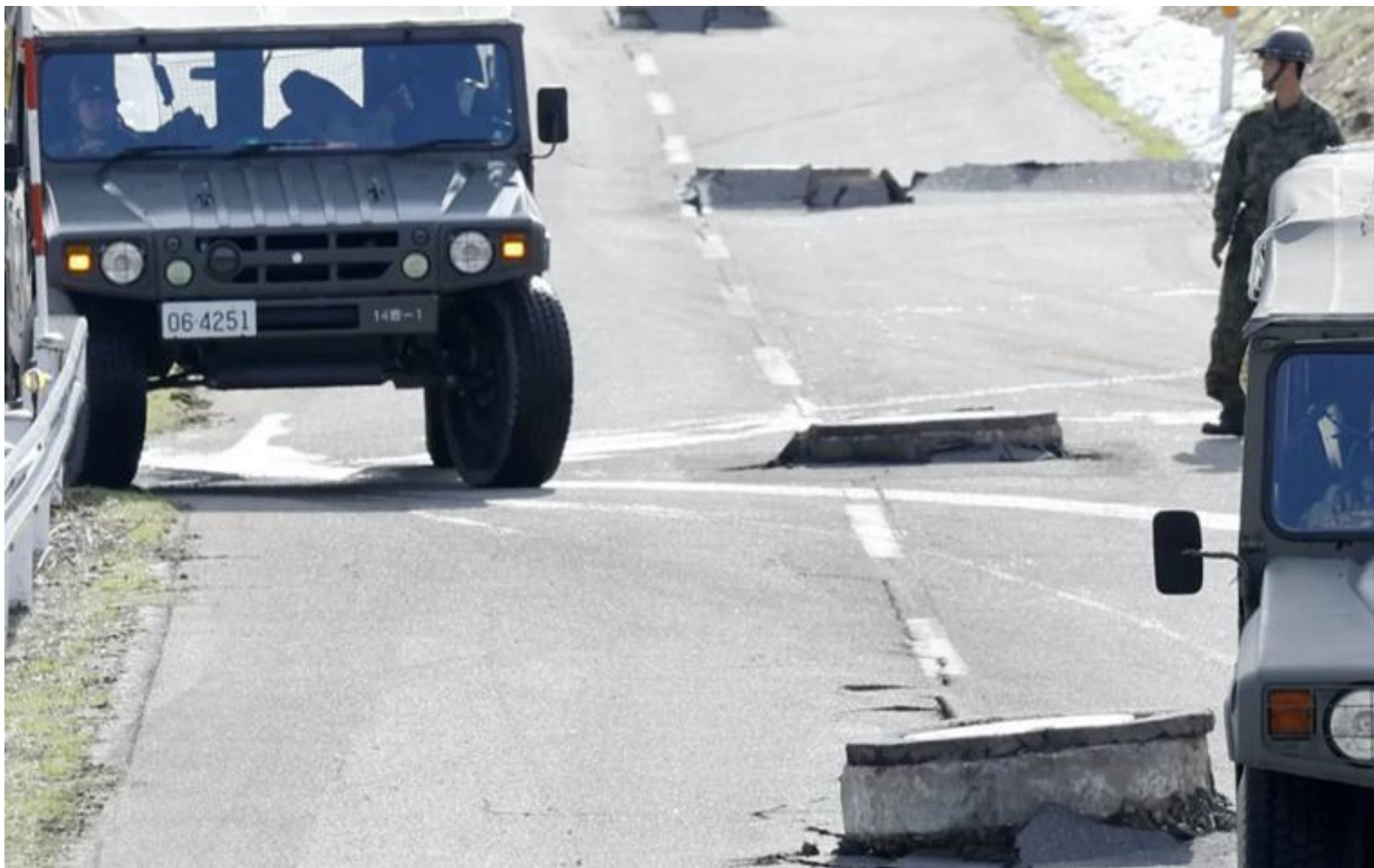
珠洲市 地震によって突き出たマンホール (甲F152)
