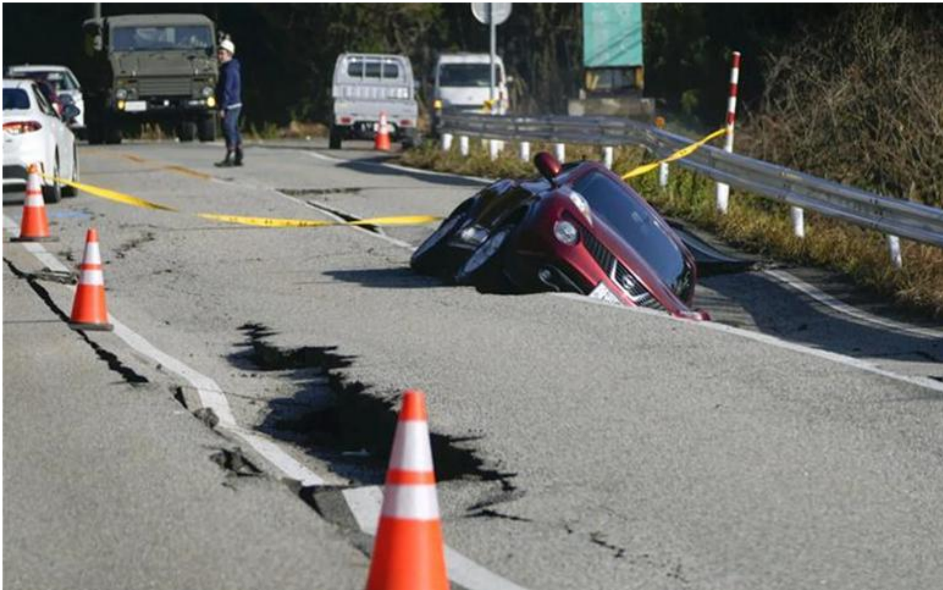
穴水町 道路の陥没に車両が落ち込んでしまった事態 (甲F152)
