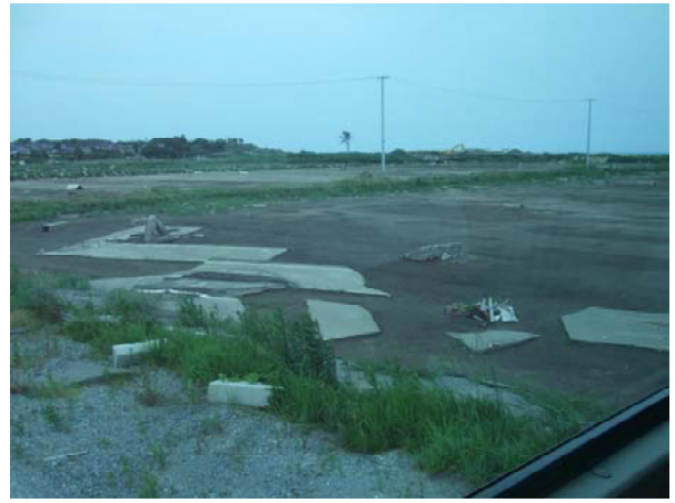
津波ではがれ落ちた道路舗装
