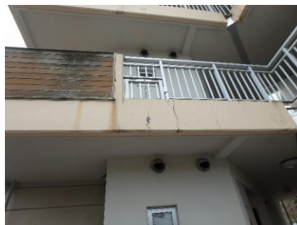
弥生団地(特公賃)：鉄筋露出、ひび割れ
