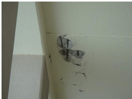
湯浜団地(2号棟)：鉄筋露出
