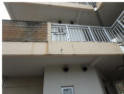
弥生団地(特公賃)：鉄筋露出，ひび割れ
