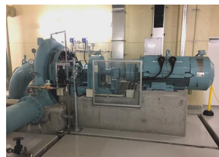
赤川高区浄水場構内の 小水力発電設備
