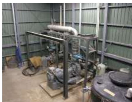
温泉供給ポンプ
