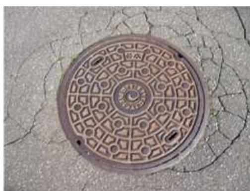
水密性の低いマンホール蓋
