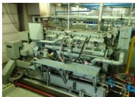
ガス発電設備
