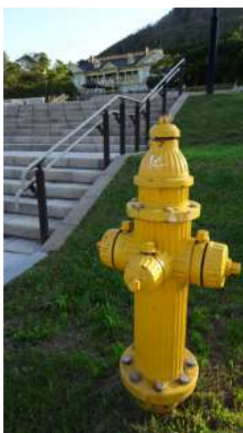
函館市型地上式消火栓
