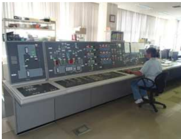
汚水処理施設運転管理
