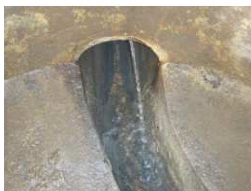
劣化による隙間からの侵入水
