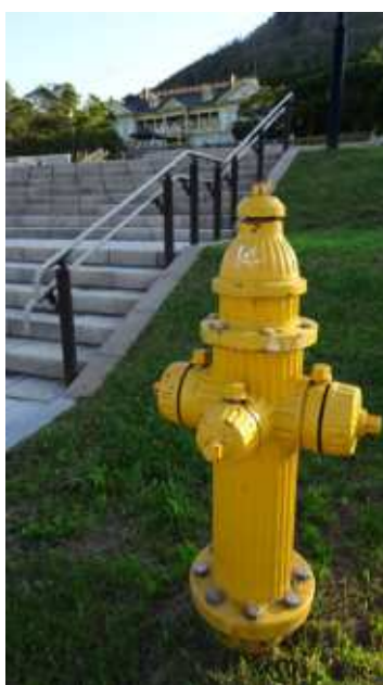
函館市型地上式消火栓
