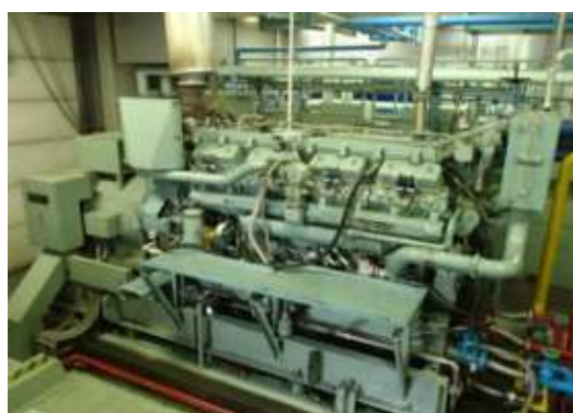
ガス発電設備
