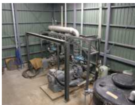
温泉供給ポンプ
