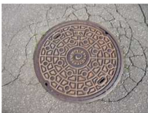
水密性の低いマンホール蓋
