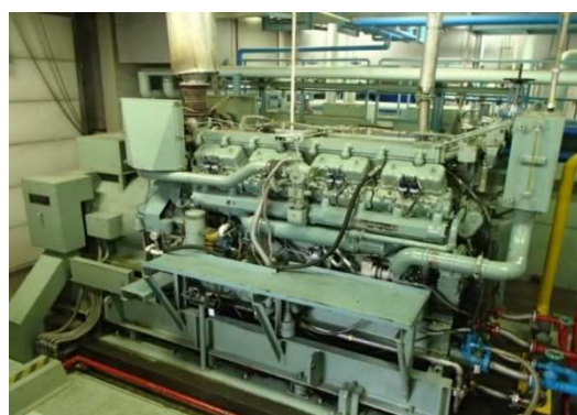
ガス発電設備
