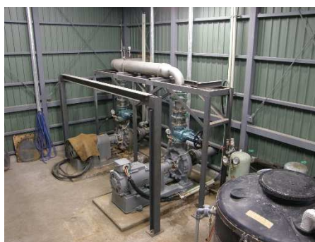
温泉供給ポンプ
