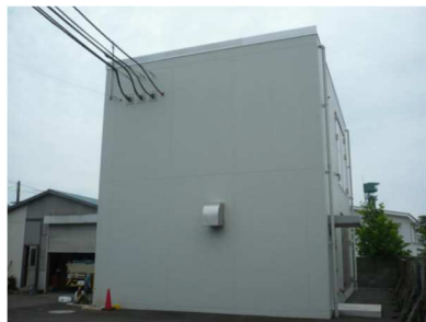
駒場町変電所
