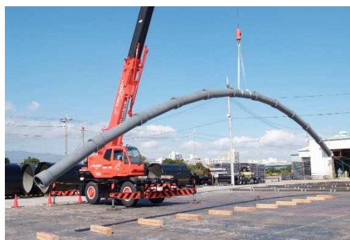
耐震継手の水道管
