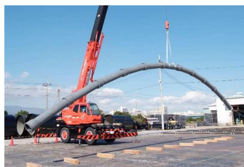
耐震継手の水道管
