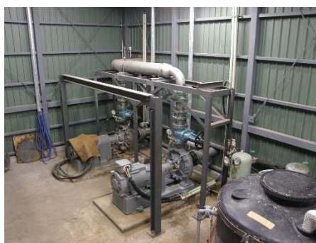
温泉供給ポンプ
