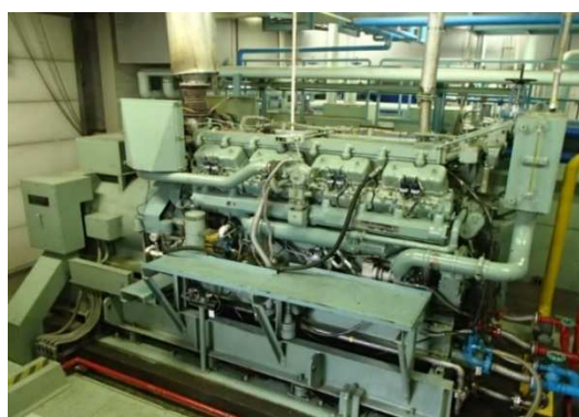
ガス発電設備
