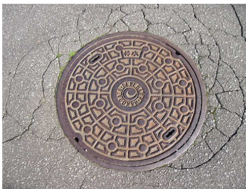
水密性の低いマンホール蓋
