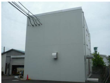
駒場町変電所
