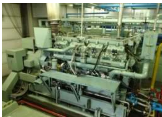
消化ガス発電機
