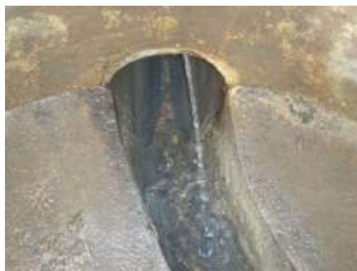
劣化による隙間からの侵入水
