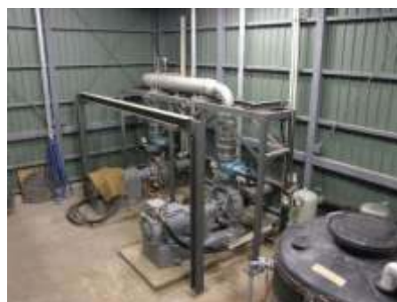
温泉供給ポンプ
