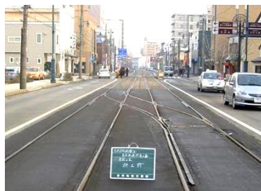
施行前・老朽化の激しい分岐器の状態
