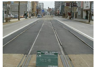
施工後・見た目はあまり変化無いが、レール状態などは良好
