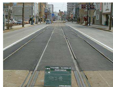
施工後・見た目はあまり変化無いが、レール状態などは良好
