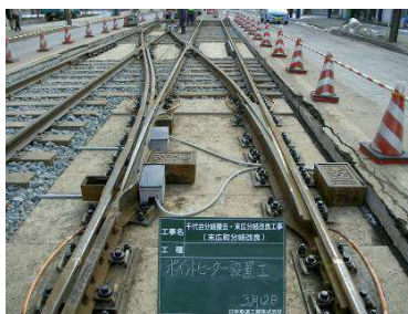
分岐器を千代台から移設し、ポイントヒーター（凍結防止ヒーター）を設置している状態
