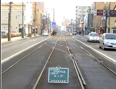
施行前・老朽化の激しい分岐器の状態
